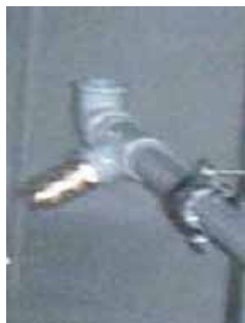
Instalación de aire comprimido
